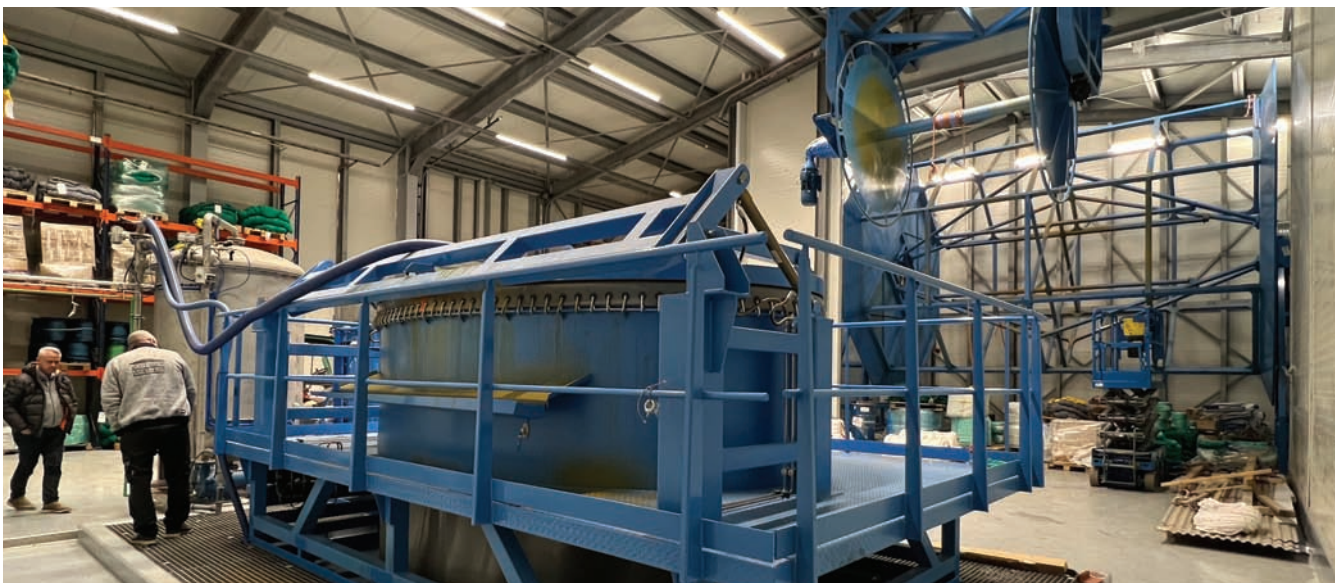
Litunaraðstaða fyrir fiskeldiskvíar í nýju fiskeldisþjónustustöðinni á Ísafirði.
